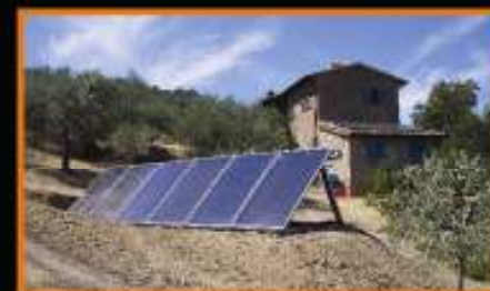
Panicale (PG): casa rurale autosufficiente con impianto fotovoltaico a letto e impianto solare termico a terra
