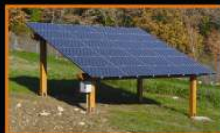
Monte Castello di Viblo (PG): impianto fotovoltaico installato su pensilina in legno
