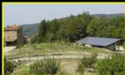
Palazzo del Pero (AR): impianto fotovoltaico installato su pensilina in legno per parcheggio di agriturismo.
