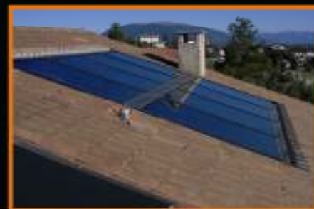
Ripa (PG): impianto solare termico con installazione totalmente integrata al posto delle tegole per abitazione privata
