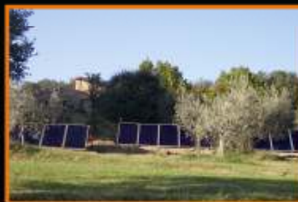
Montecastello di Vibio (PG): impianto solare termico con installazione a terra per agriturismo
