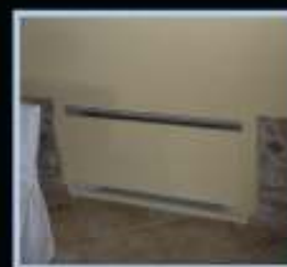
Impianto a fan coil ad incasso
