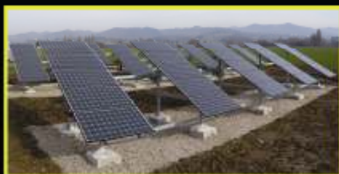
Località Parfesa (PG): piccola centrale fotovoltaica (20 kWp) ad inseguimento monoassiale per vendita di energia .
