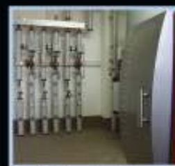
Centrale termica multisorgente
