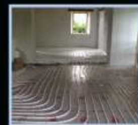
Impianto a pavimento
